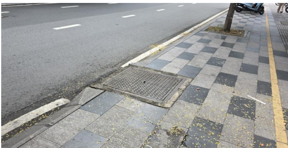
Hình 3: Hình ảnh hiện trạng hố ga đầu nối thoát nước
